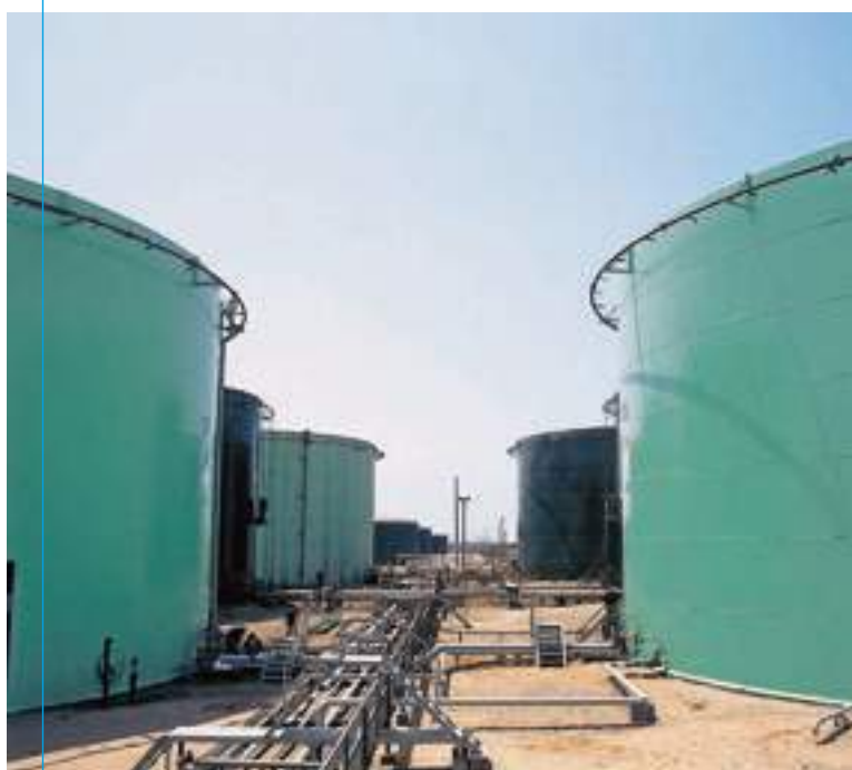
Refinería La Pampilla S.A.
